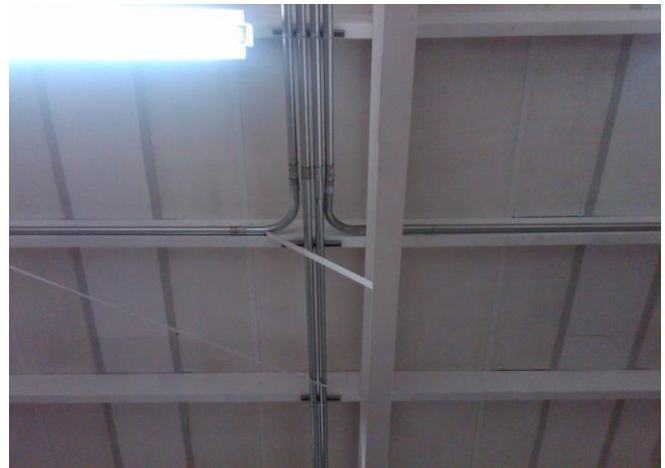
Tendido de tubo galvanizado pared delgada para acometida secundaria de equipos de aire acondicionado, Super Aki
